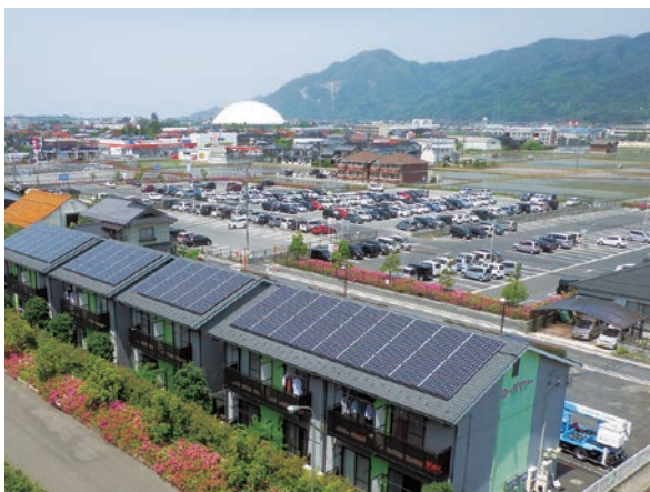
集合住宅屋上に設置された太陽光パネル=出雲市内
